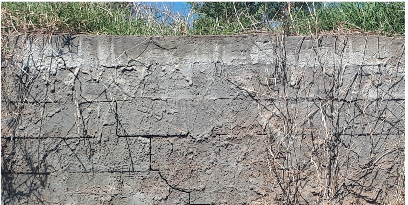
Ruptura do muro: Ruptura do muro de arrimo com ausência de projeto estrutural.
