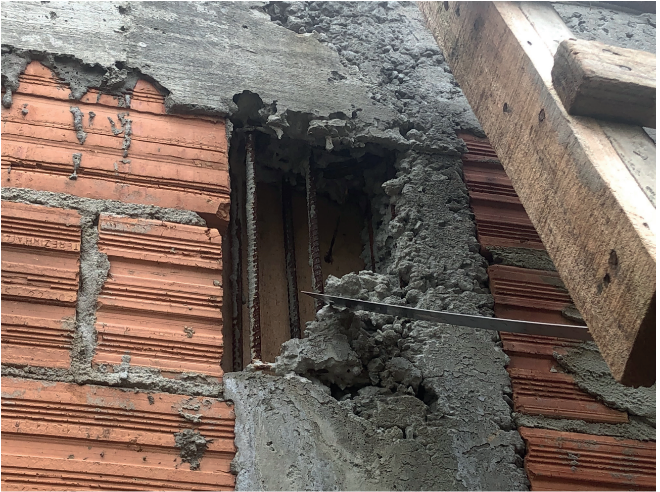
Pilar estrutural: Pilar estrutural com falha na concretagem, dimensões e ferragens em desacordo com as normas técnicas.
